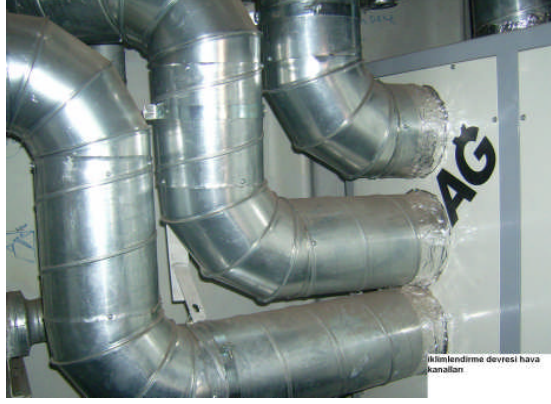
Resim 1.7: Havalandırma damper bağlantısı
