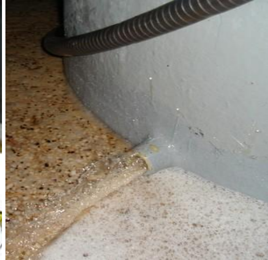
Resim 2.6: Kostikli suyun boşaltılması
