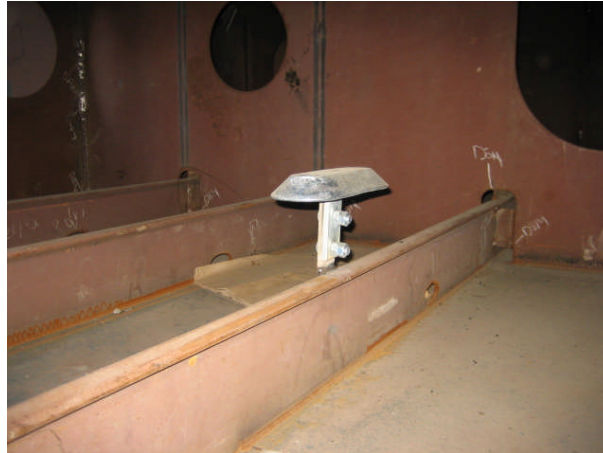
Resim 2.1: Balast tankının tuty ile katodik korunması
