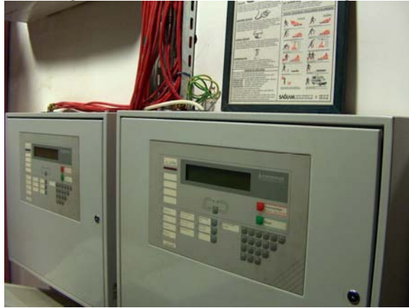
Resim 1.9: Yangın Alarm Sistemi
