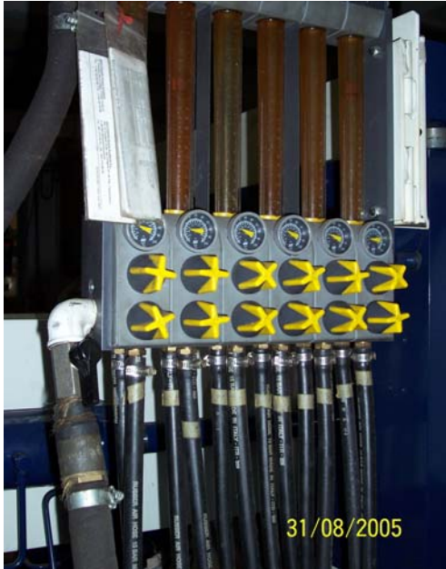
Resim 1.9: Soğutma kontrol ünitesi
